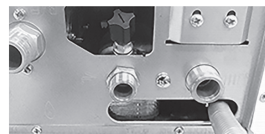
Дренажный патрубок предохранительно-сбросного типа (справа снизу)
